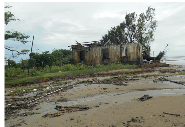
Figura 3.3: Casa destruída pela erosão costeira em maio de 2018. Praia do Goiabal, município de Calçoene (AP). Fonte: Lana Nunes – Projeto SISPRAM/IEPA.
