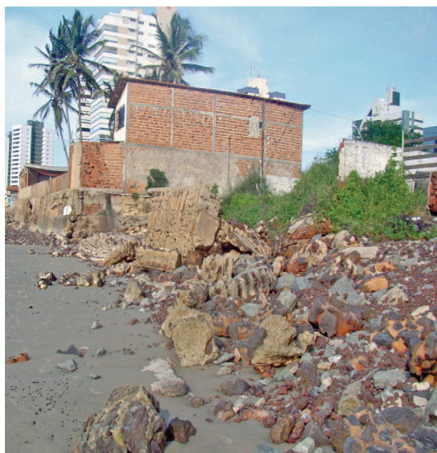
Figura 3.4: Destrução da orla, do calçadão e das obras de contenção em decorrência da erosão costeira. Praia Ponta d'Área – município de São Luís – MA (2017). Fonte: Sidney Barros.
