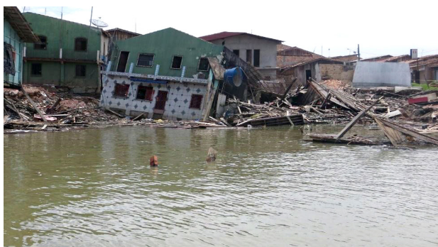
Figura 5.3: Área aterrada com caroços de açaí, resíduos de madeira e lixo urbano, utilizada para ocupação urbana. O colapso do solo resultou na destruição das moradias. Município de Abaetetuba (PA), 2014. Fonte: Foto de Dianne Fonseca.
