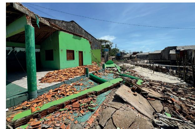
Figura 3.6: A migração de canal de maré em direção à praia, contribuindo para a erosão e a consequente destruição de ruas e residências na Praia do Crispim (município de Marapanim, estado o Pará), em junho de 2025. Fonte: Almir Costa.
